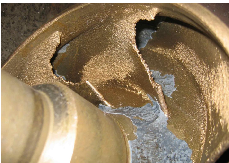
Рисунок 1. Поврежденная из-за кавитации крыльчатка насоса
